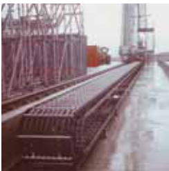
Catene 35 dotate di carro mobile applicate su impianto di De Icing presso l'aeroporto di Monaco di Baviera D. Lunghezza corsa m. 90 Velocità di scorrimento m 90 al minuto.
