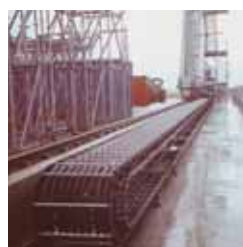
Catena tipo 35 con carro di supporto applicata su impianto di De Icing presso l'aeroporto di Monaco di Baviera.
